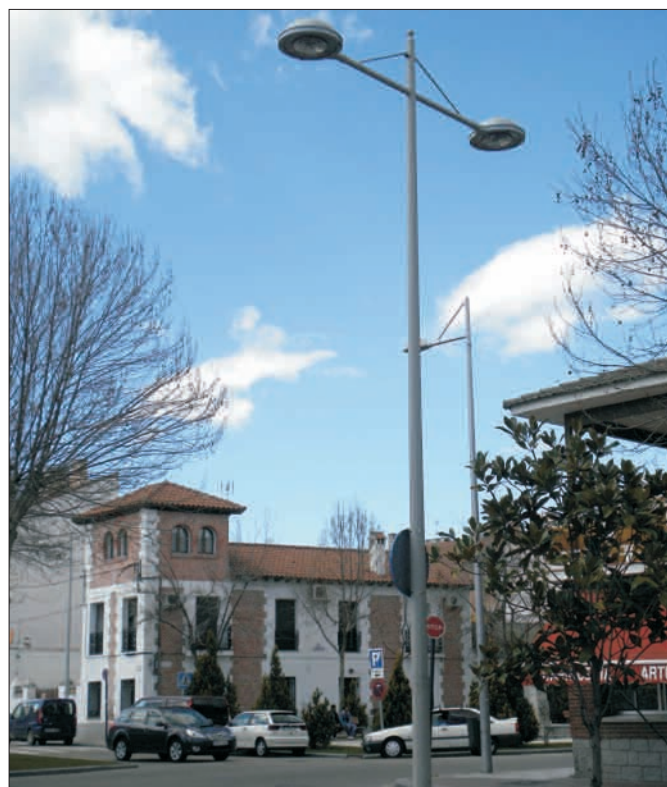
Imagen de las luminarias con tecnología LED instaladas en el casco antiguo.
